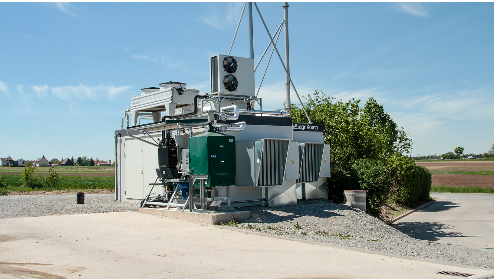
Das Gasreinigungssystem vor dem schlüsselfertigen Betonbehälter einer AgriKomp Biogasanlage.
